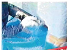
ホテル外壁塗膜剥離
