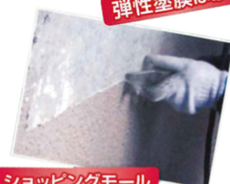
ショッピングモール 外壁塗膜剥離
